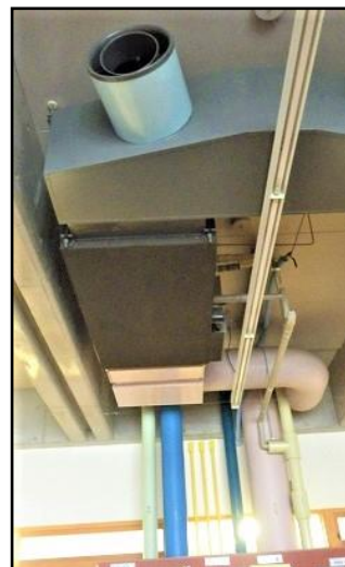
A 配管の見える化
